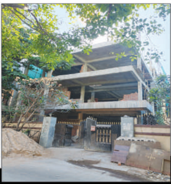
బంజారాహిల్స్ ఎమ్మెల్యే కాలనీలో ఓర్ట్ భవనంపైన ఎలాంటి పర్మిషన్ లేకుండా మూడంతస్తుల నిర్మాణం
